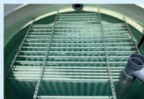
◀バイオモジュール槽
